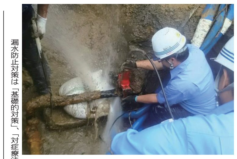
漏水防止対策は「基礎的対策、対策的対策、予防的対策」の3つに分けられる
