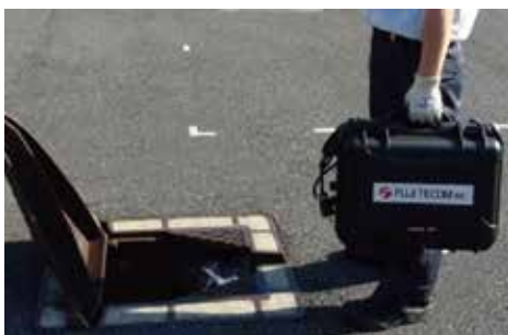
監視盤が設置できない場所でも※
